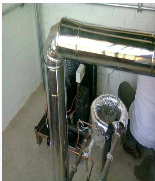
Unidad de frio para banco de hielo Planta Piloto de Lácteos
